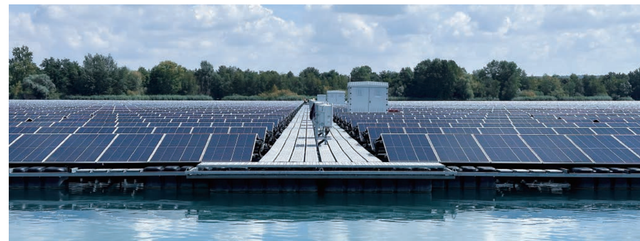
ドイツ水上発電所プロジェクト 設置時期: 2024
